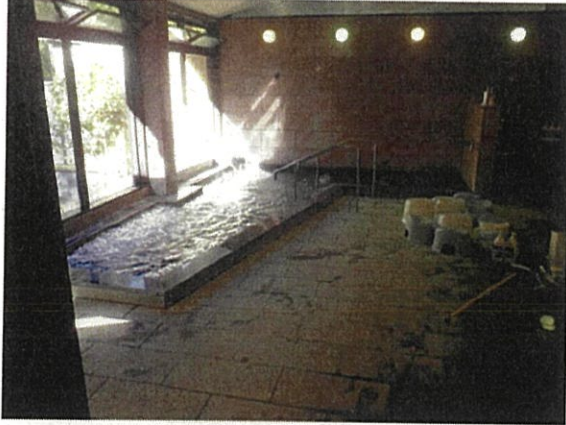
⑥-2 浴室・脱衣所
