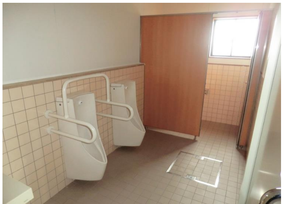
⑩ 便所棟(内部)
